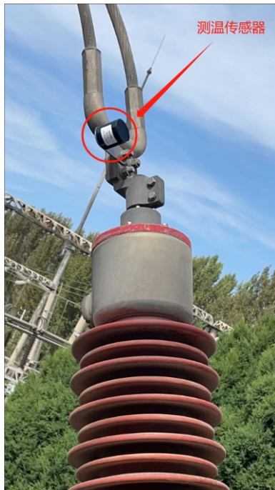
变电站内变压器高(中)压套管头测温
