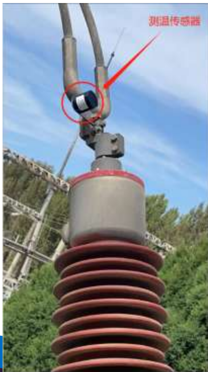
变电站内变压器高(中)压套管头测温
