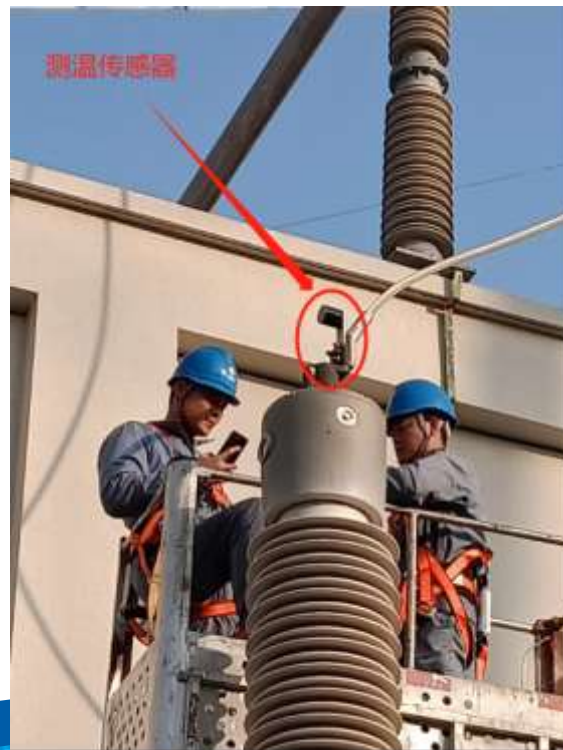
安装在1000kV换流站内
